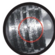
DAÑOS EN EL PISTÓN DE LA BOMBA
